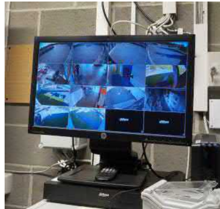
Kameravalvontajärjestelmän katselupiste teletilassa
