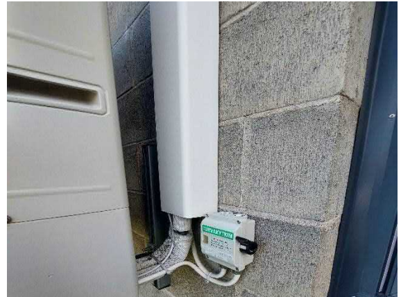
Ulkoyksikön turvakytin ja kylmäaineputket suojakourussa.
