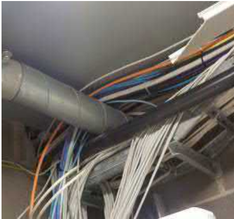
Johtoreitti täynnä kaapelia teletilassa
