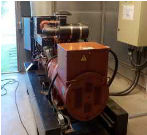
Varavoimalaitteisto teknisessä tilassa
