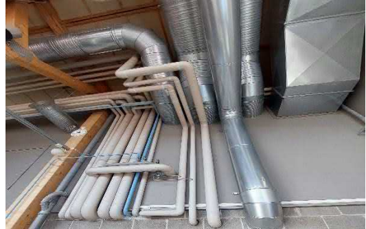
Eristetyt lämpölinjat autohallissa.
