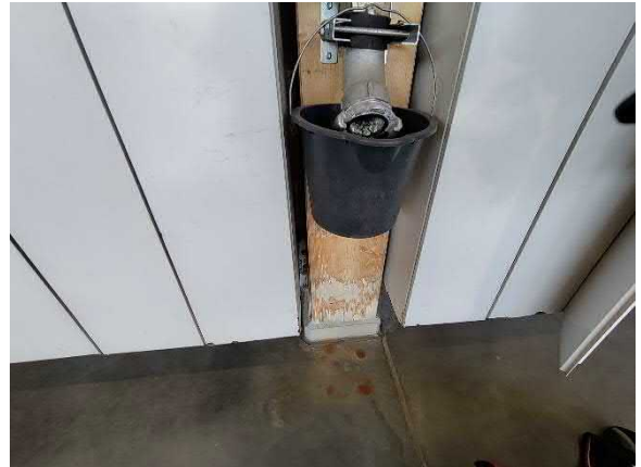
Puupilarin alaosaassa kosteusjälkiä
