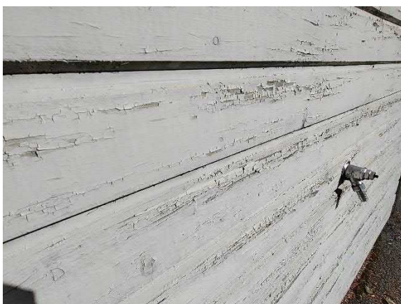
Puupintojen maali hilseilee varastohallissa
