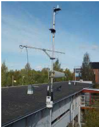
Antenneja vesikatolla yhteismastossa
