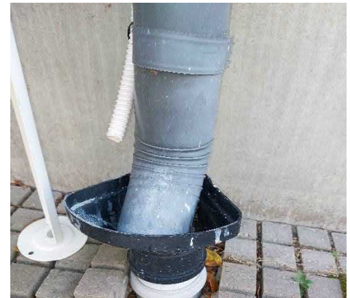
Kattosadevedet johdettuna rännikaivoon.
