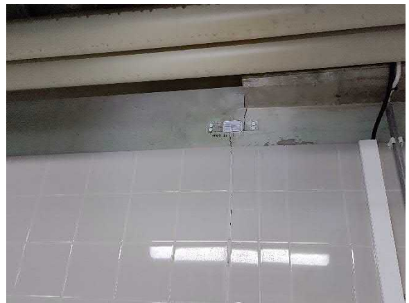
Kantavassa väliseinässä halkeama
