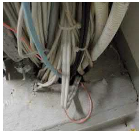
Läpivienti teknisessä tilassa
