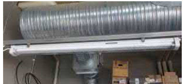
Uudempi LED-valaisin kalustohallissa
