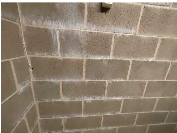
Harkkoseinässä mahdollisesti rakennusaikaisia muurauslaastin jälkiä
