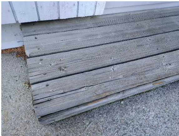
VSS:n kattotasanteen oven porras on huonokuntoinen
