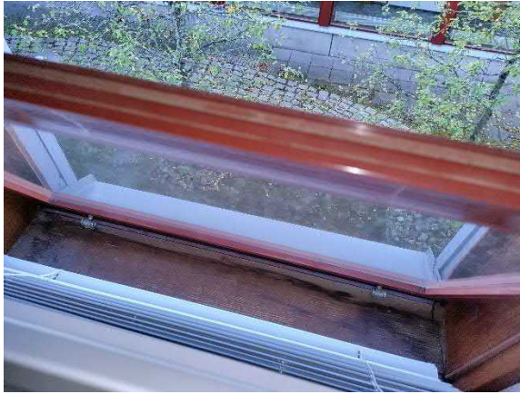
Ikkunakarmin alaosassa kosteusjälkiä
