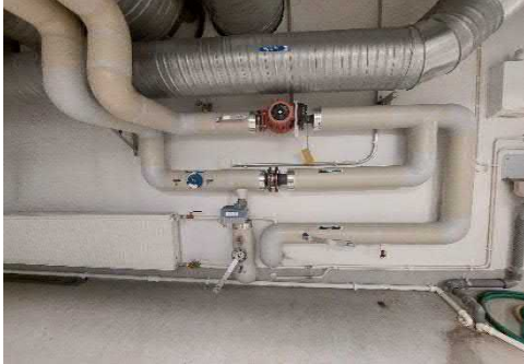
Ilmanvaihtokoneen lämmityspatterin suntti-ryhmä IV-konehuoneessa.
