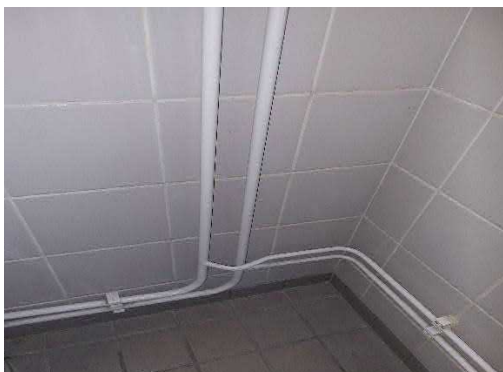
Kupariset kytkentäjohdot wc-tiloissa.
