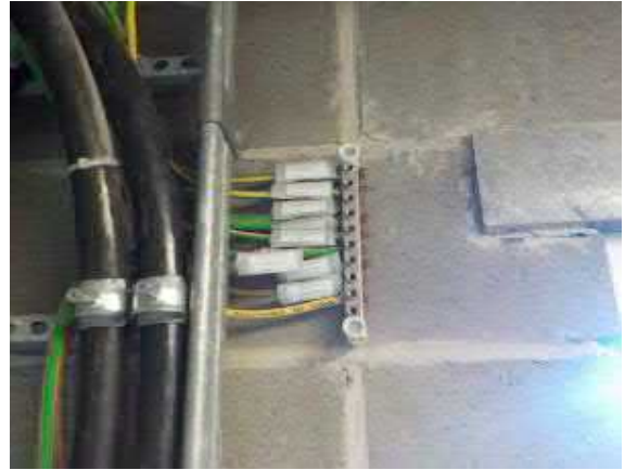
Maadoituskisko pääkeskuksen yhteydessä
