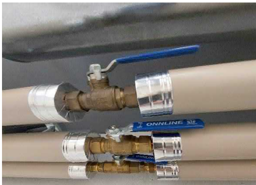
Käyttövesiverkoston alkuperäiset sulkuventtiilit.
