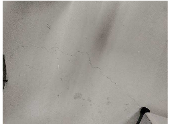
Varastotilan alapohjassa havaittiin halkeamia
