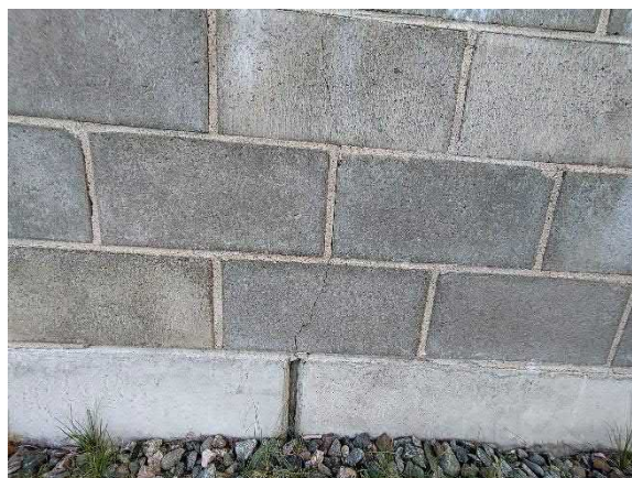
Halkeama harkkomuuratussa seinässä
