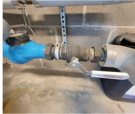
Vesimittarin alkuperäinen sulkuventtiili.
